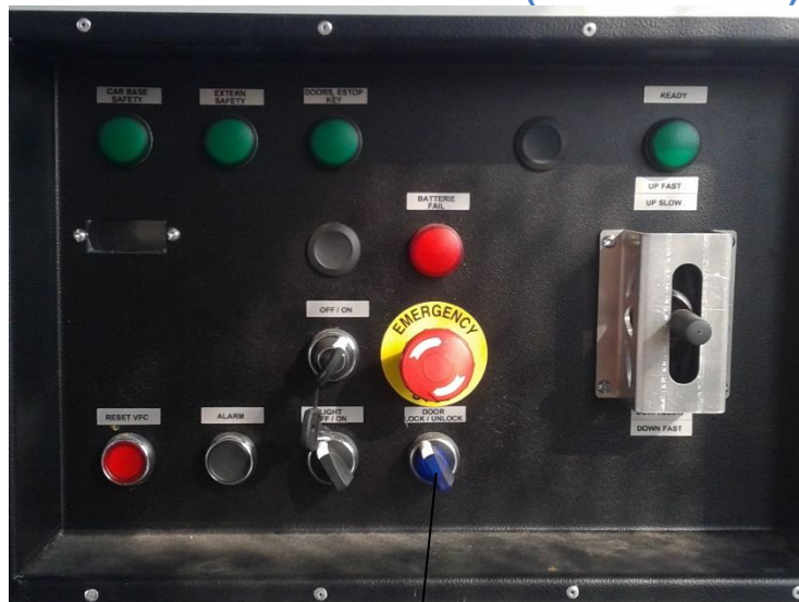
FIG. 1 - PANNEAU DE CONTRÔLE (DANS LA CABINE)
